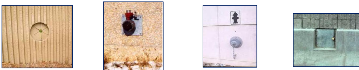
Рисунок 6.34 - Пожарные гидранты в шумозащитном экране
